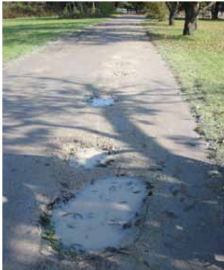
Schlaglöcher vor der Sanierung (Foto: Martin Hanke)
