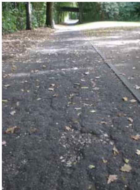
Sanierungsfall: Radweg Münchener Straße
